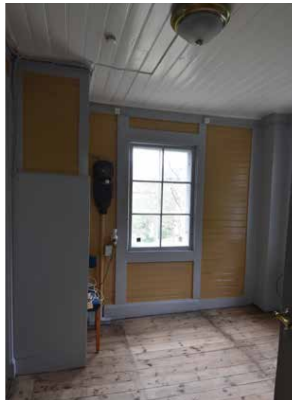
Vy mot norr. Linoleummattan som låg på golvet har tagits bort. Notera det åtgärdade taket. Jämför med bild sid.8
