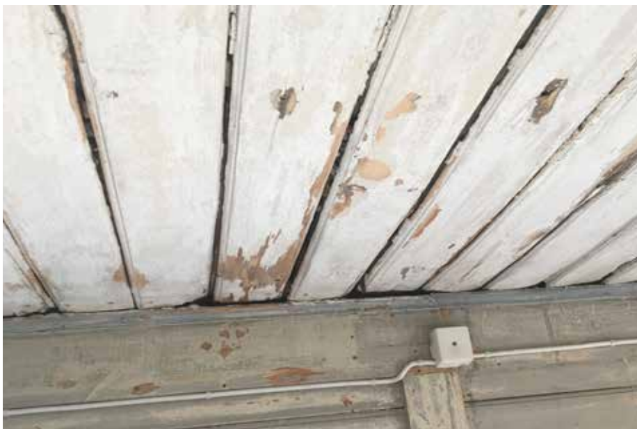
Övre bilden, rötskadad fasadpanel. Undre bilden, skadade takbrädor i sakristian
